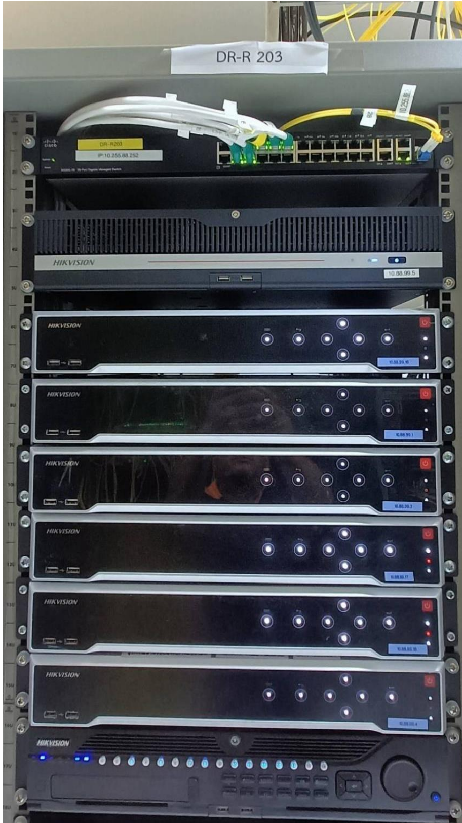
ภาพที่ 4.8 ภาพ NVR ติดตั้งที่ห้องควบคุมระบบ DR Site
