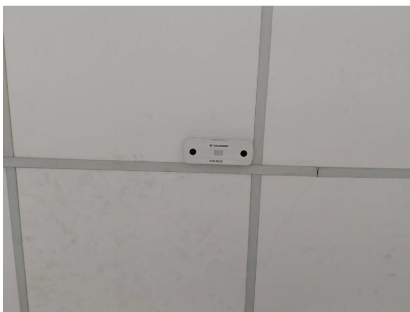
ภาพที่ 4.4 ภาพการติดตั้งกล้อง AI บริเวณเพดาน ประตูทางเข้า-ออกของอาคารศูนย์สารสนเทศ ชั้น 5
